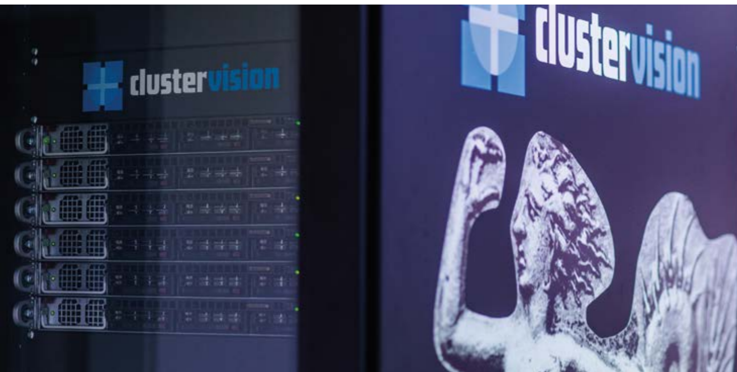
Abb. 93: Server im Hochschulrechenzentrum der JLU.
